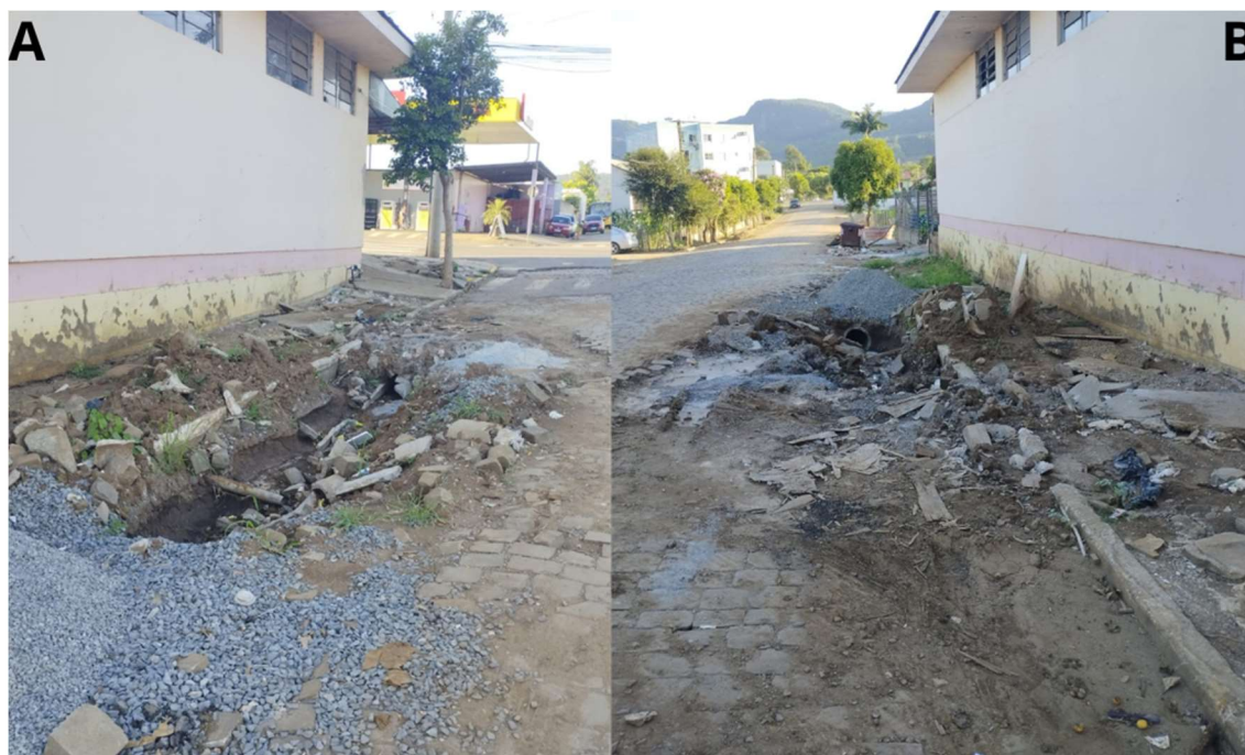
Figura 5 - Via e rede de drenagem urbana danificadas na Rua 31 de Outubro, bairro Cidade Nova (ponto 1).
