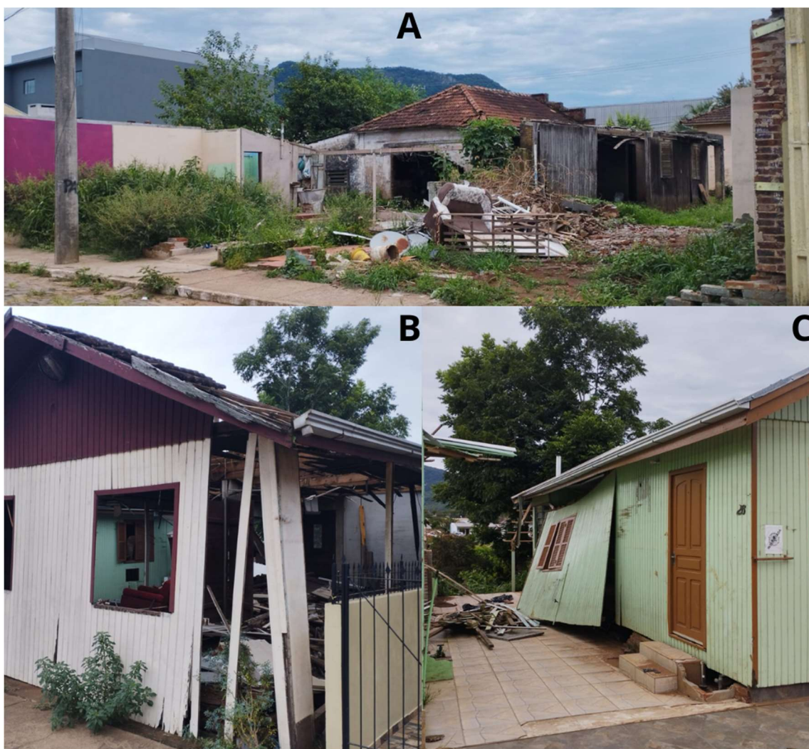
Figura 6 - Escombros e casas destruídas na Travessa Berger (ponto 2).
