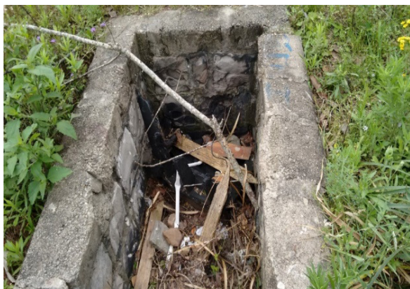
Figura 7 - Fotografia de bueiro que deveria servir para escoar a água pluvial, sem proteção e atulhado de resíduos.
