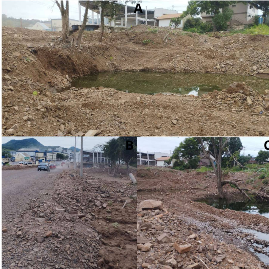
Figura 9 - Danos estruturais na canalização do Arroio Sete de Setembro e na Av. General Daltro Filho (ponto 4).
