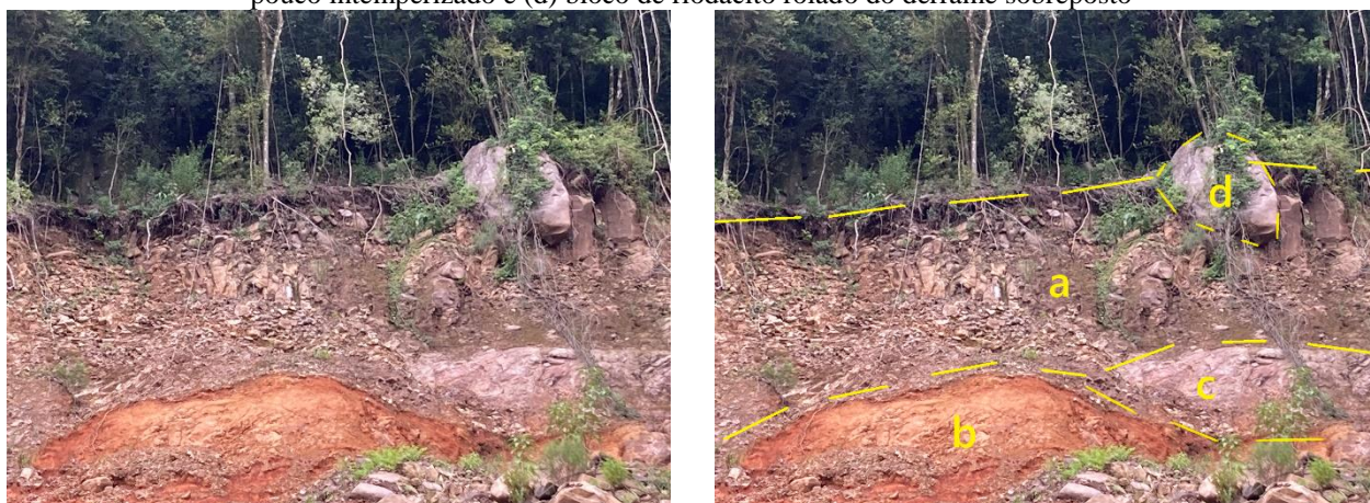
Figura 15 - Visão em detalhe ruptura vista na cicatriz de deslizamento em Bento Gonçalves da Figura 13, expondo (a) maciço rochoso de riodacito fraturado, (b) maciço rochoso riodacito muito intemperizado, (c) maciço de riodacito pouco intemperizado e (d) bloco de riodacito rolado do derrame sobreposto
