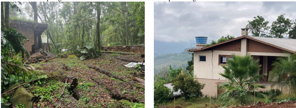
Figura 18 - Visão de terreno expondo trincas de tração no Município de Nova Petrópolis (foto de CEMADEN 2025b) e de uma edificação danificada no Município de Bento Gonçalves causadas por movimentação do terreno do tipo rastejo, tipologia de movimento de massa não detectável pelas imagens de satélite utilizadas
