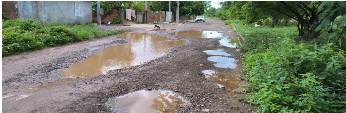
Figura 11 - Ruas sem pavimentação com pouca manutenção e problemas de drenagem pluvial geram alagamentos na vila Km3.
