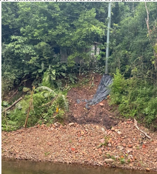
Figura 15 - Residência com processo de erosão de margem na vila Schirmer.
